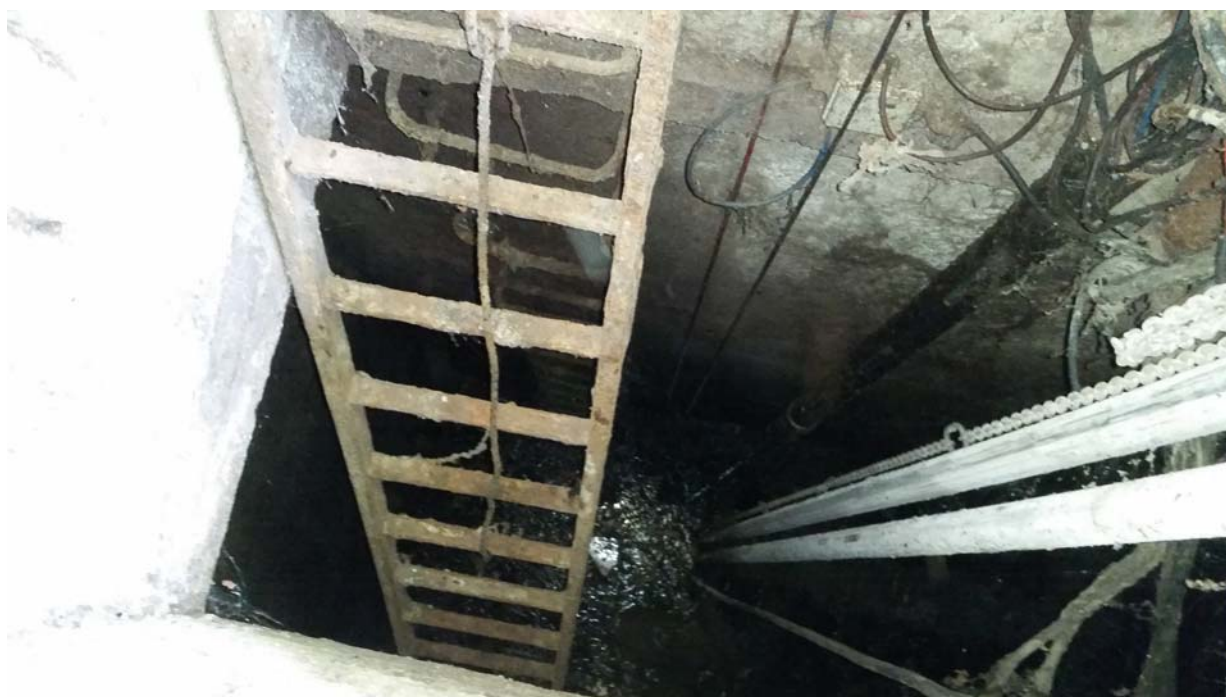
Fotografia 02 – Vasca alloggiamento delle pompe
