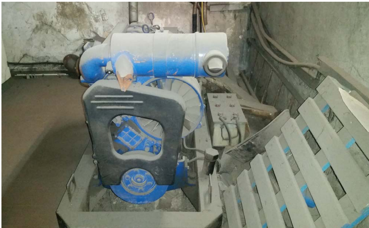
Fotografia 06 – Gruppo elettrogeno di sicurezza
