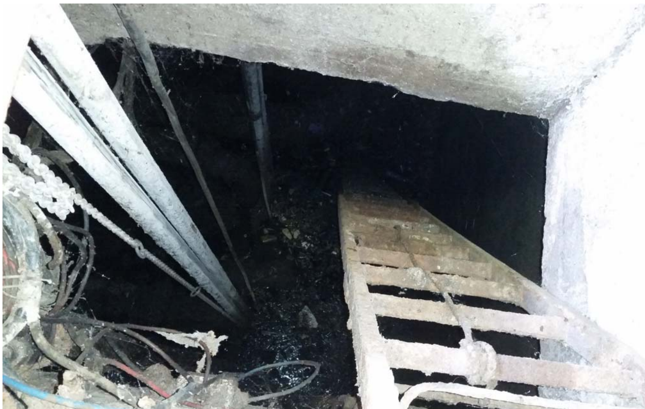
Fotografia 03 – Vasca alloggiamento delle pompe
